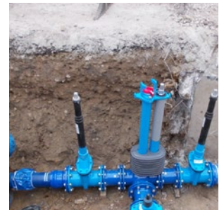
Gas-, Wasser- und Nahwärmeversorgung
